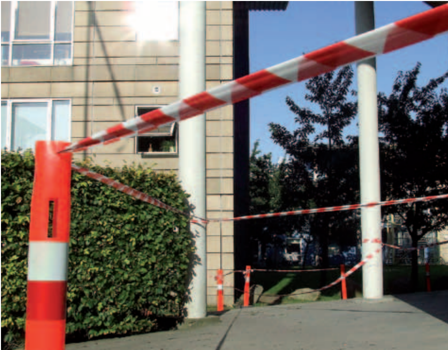
Odinsgård afspærres pga. fare for nedfaldende vinduer.
