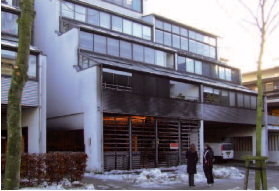
Især lejligheden lige over branden blev skadet
