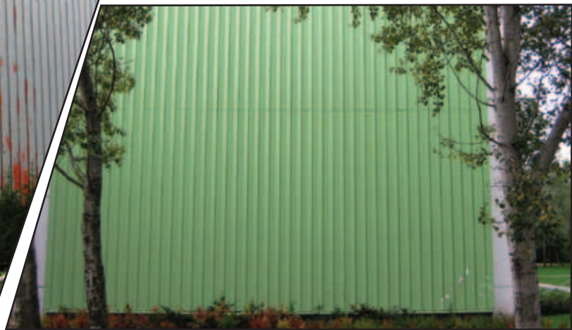
Efter renovering. Nogle steder skaller den nye maling.
